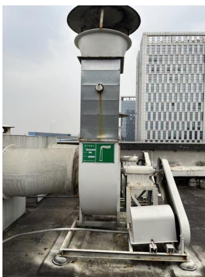
新建 5#排气筒及活性炭箱
