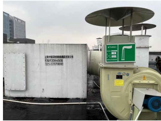
依托 4#排气筒及活性炭箱
