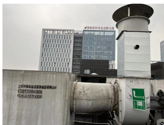
依托 2#排气筒及活性炭箱
