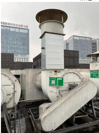
依托 1#排气筒及活性炭箱
