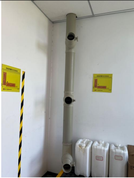
(2) 危废暂存室废气收集设施
