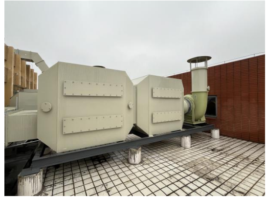
(3) 废气处理设施
