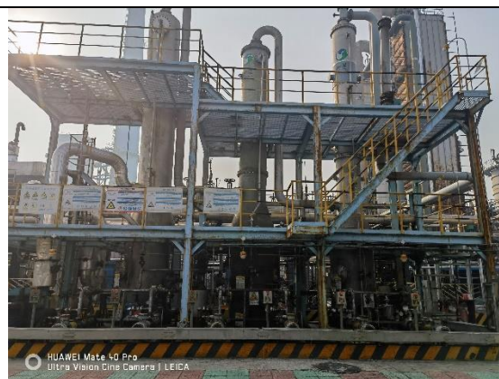
一期鼓冷预处理装置（油洗+酸洗+碱洗）
