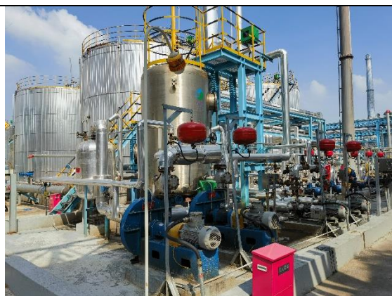
焦油储罐区预处理装置（油洗）
