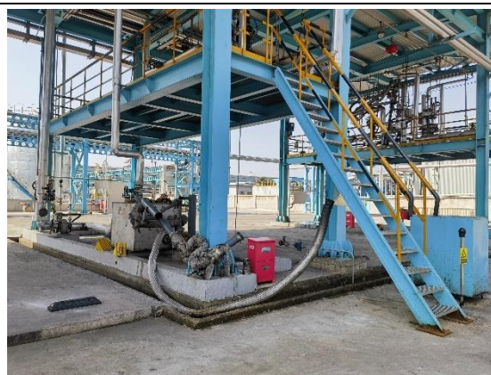
装卸站泄漏收集槽
