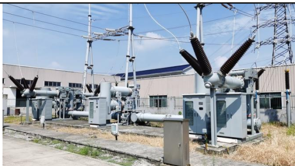
110kV 配电装置
