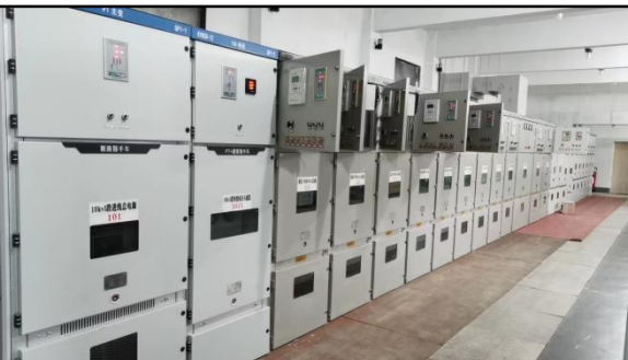
10kV 配电装置
