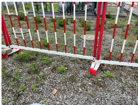
地下事故油池
