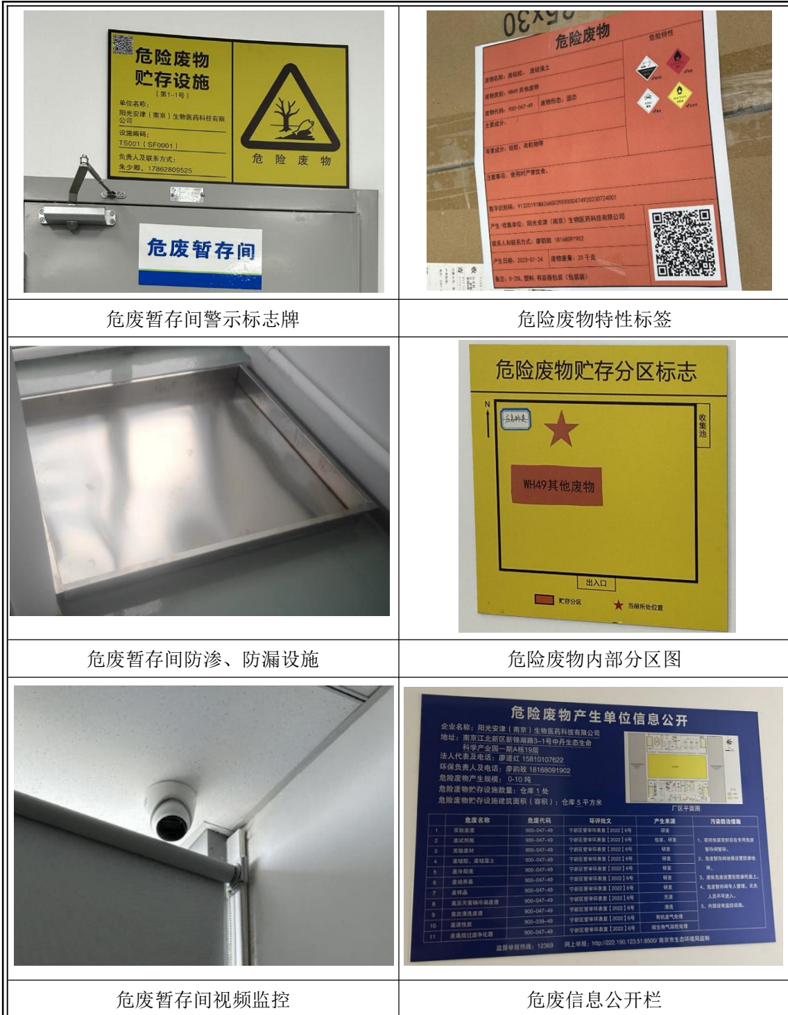
图 3-5 危废暂存间设施现状图
