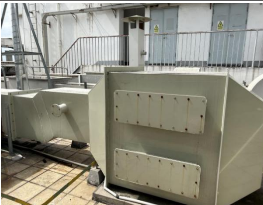
活性炭吸附废气处理设施
