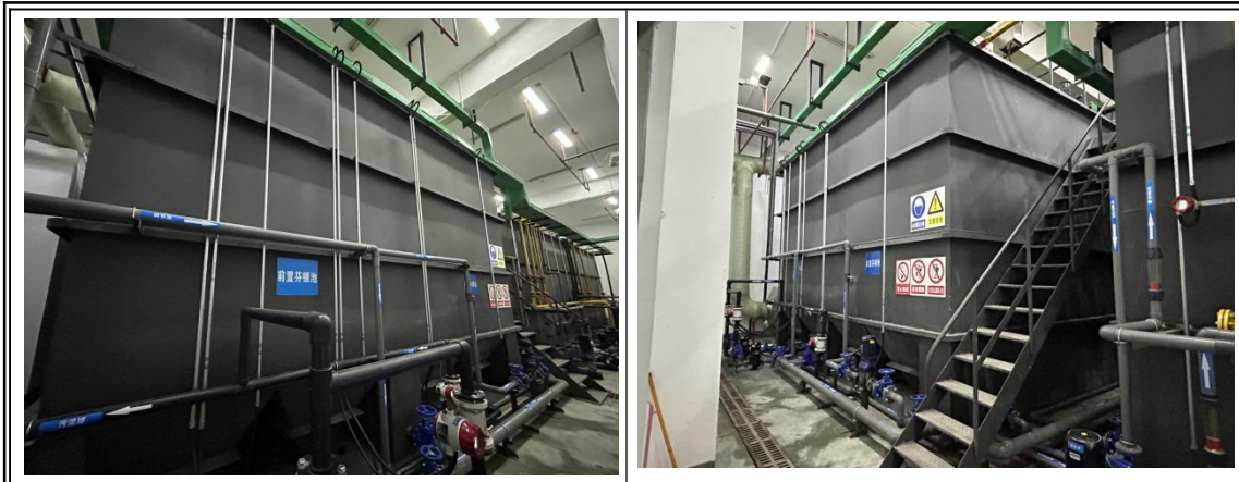
图 3-2 中丹园一期实验废水处理设施
