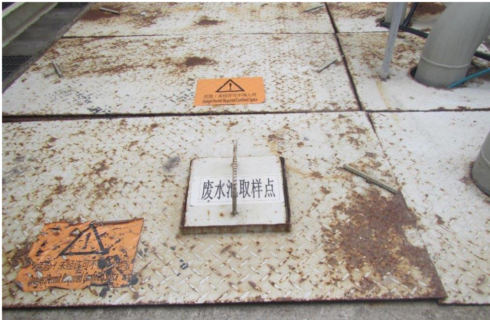
图 3-2 本项目依托复合材料（COMP）装置废水收集池
