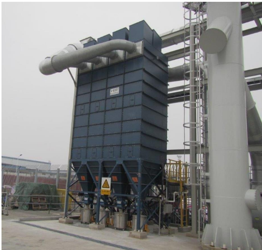
图 3-4 六号线新增袋式除尘器
